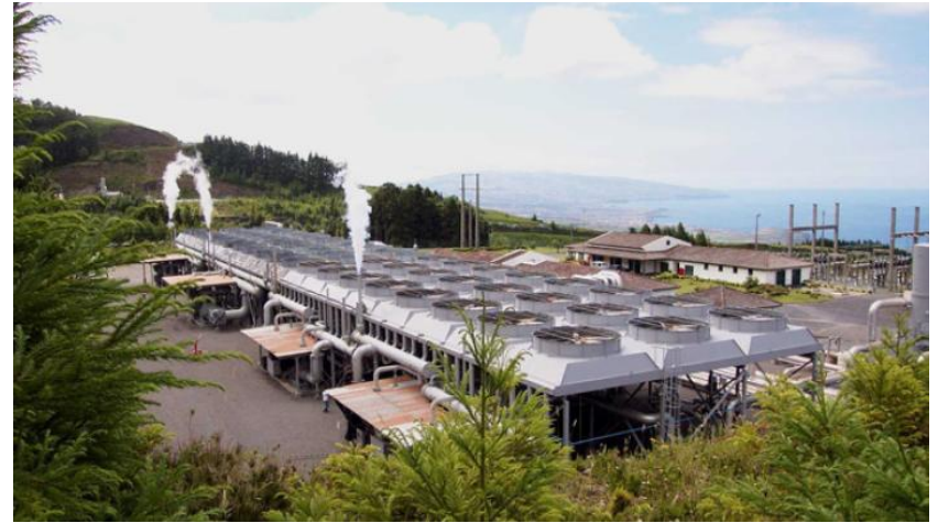
Central Geotérmica da Ribeira Grande 5 MW (1994) + 8 MW (1998)
